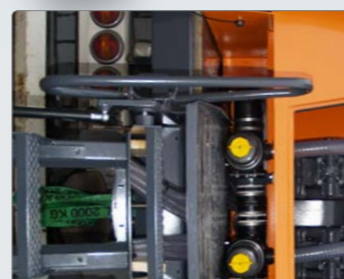
Wartungsfreundlicher Aggregatenraum mit schnellem Zugang zu der Computereinheit, der Ventile bzw. der Flüssigkeitspumpen.
